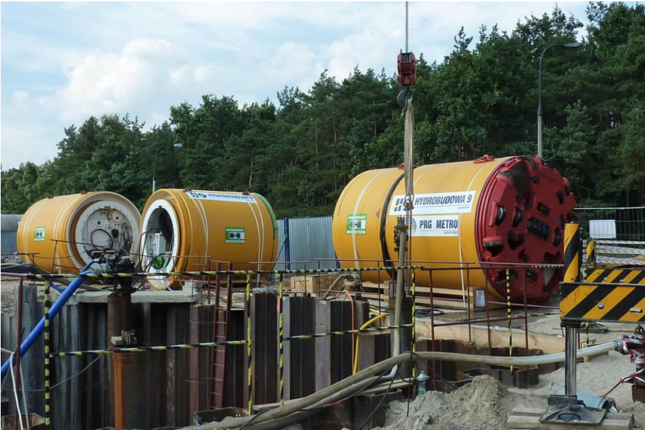
Startklar: Die Herrenknecht AVND2400AB für die unterirdische Anbindung der neuen Kläranlage in Warschau, Polen.
