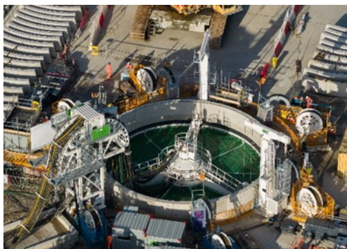
Bild 3 Vertical Shaft Sinking Machine (VSM) während des Baus des Startschachts für den Themse- Kabeltunnel. (National Grid)
